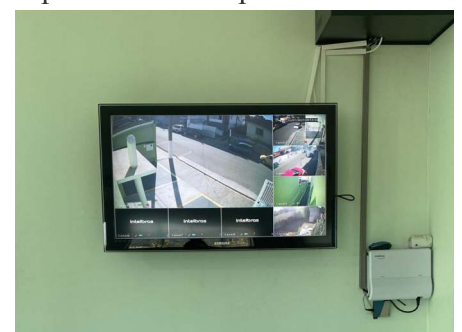
Monitoramento instalado na sala operacional
